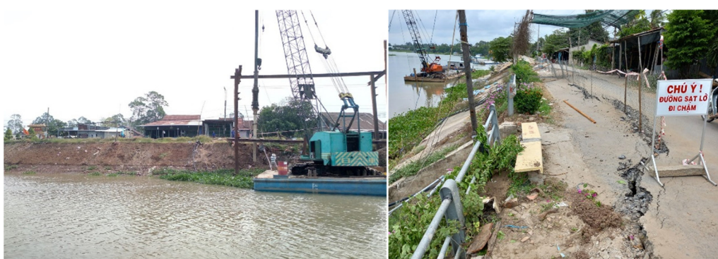
Hình 8. Xói lở bờ sông tại khu vực khảo sát.
